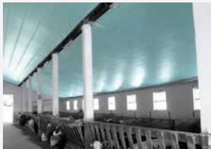
Sichtbare Wärmedämmung FIBRANxps MAESTRO schützt Stallgebäude und Wirtschaftsgebäude vor Überhitzen im Sommer und Auskühlen im Winter.
